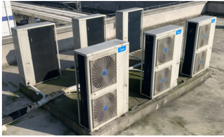
图 1 直接暴露在大气中的室外机组翅片
