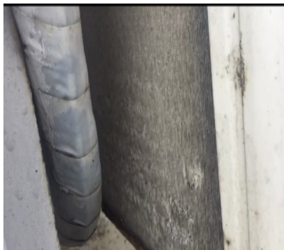
图 2 海口市被腐蚀的外机翅片
