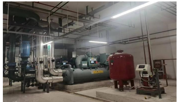
图1 制冷机房现场
